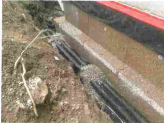
Bild 3. Dubbladräneringsrör runt huset
