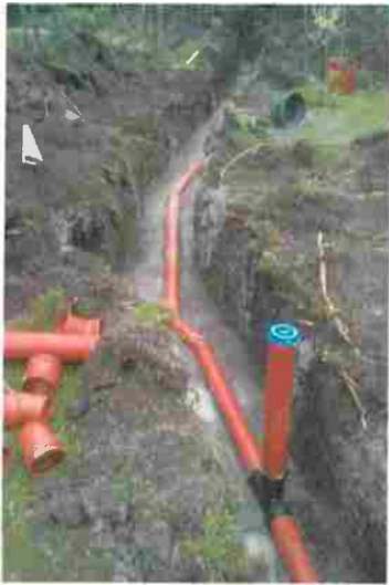
Bild 2. Dräneringsledningarna runt huset samt ner till brunnen
