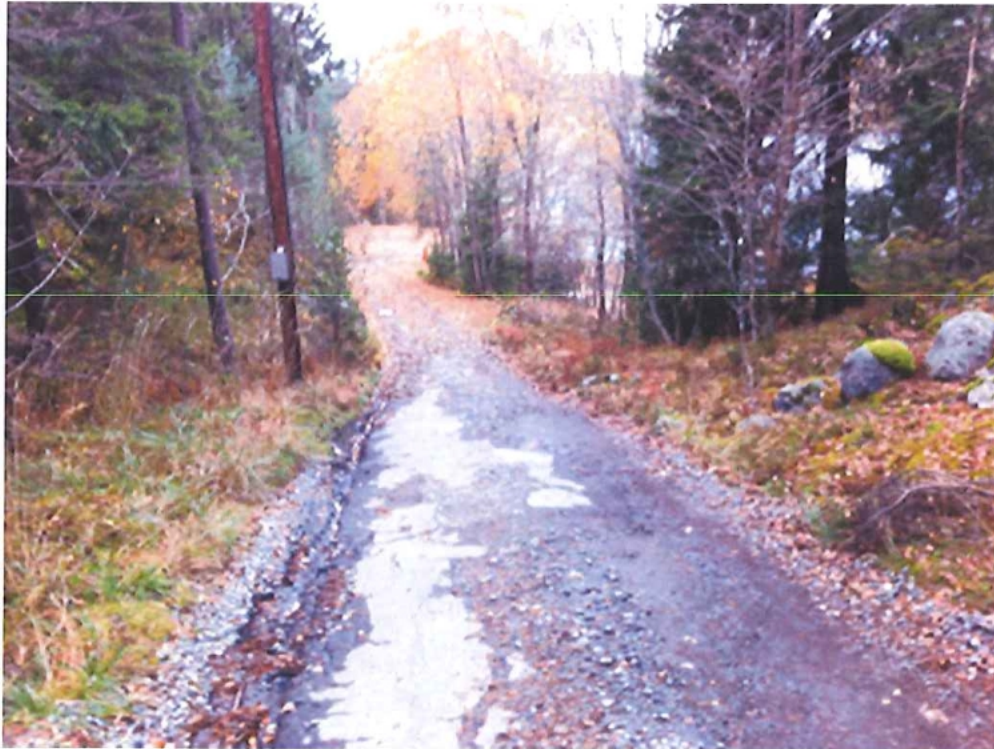
Figur 4 Vägen ner mot Skutviken med sliten asfalt under grustäcke och bitvis brant lutning och tvära kurvor.
