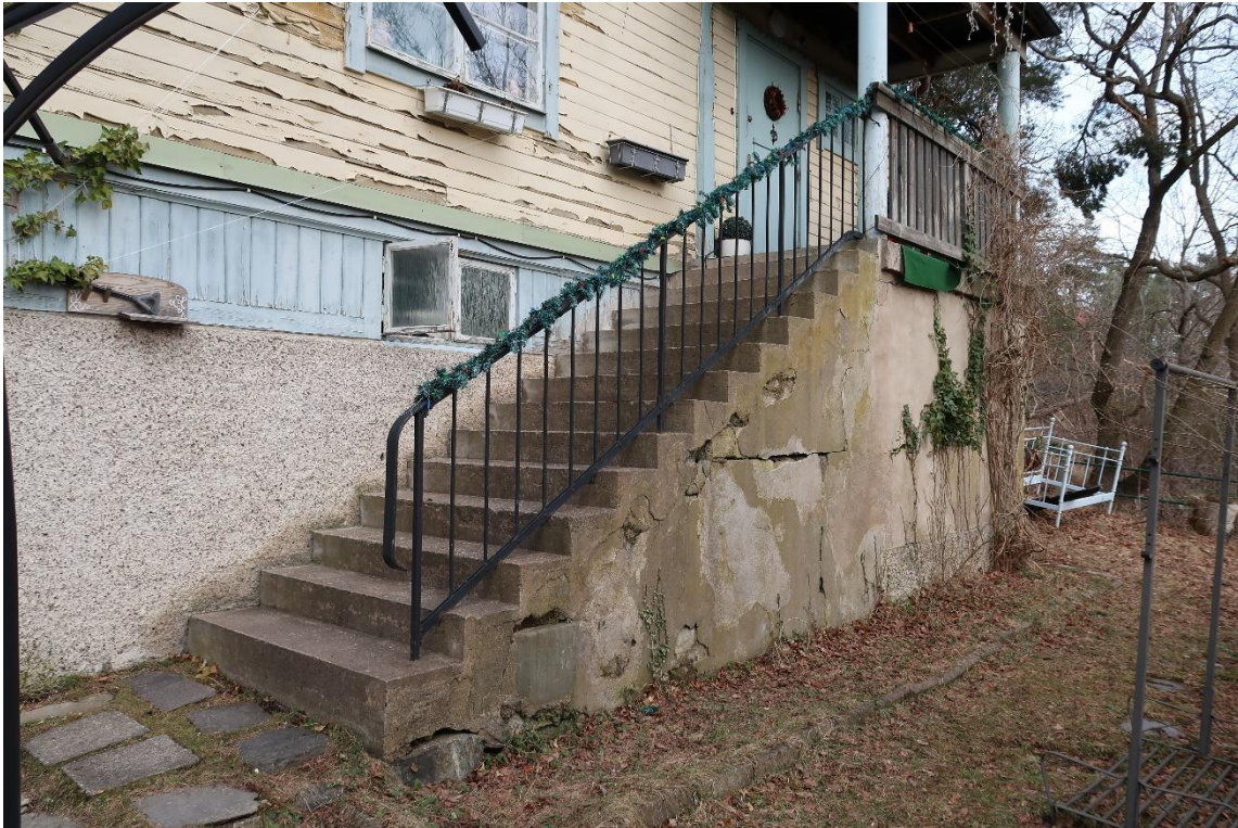
Huvudentré med trappa med stora åtgärdsbehov.
