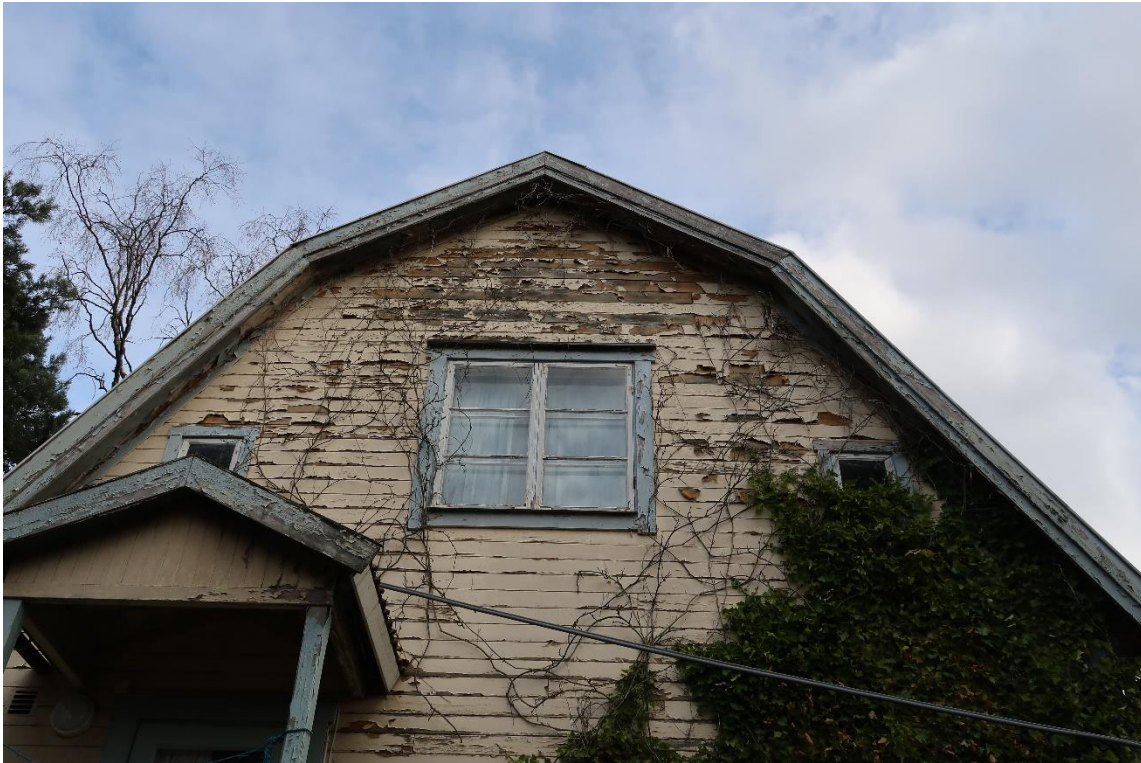
Västra gaveln med svåra skador i fasadpanelen.
