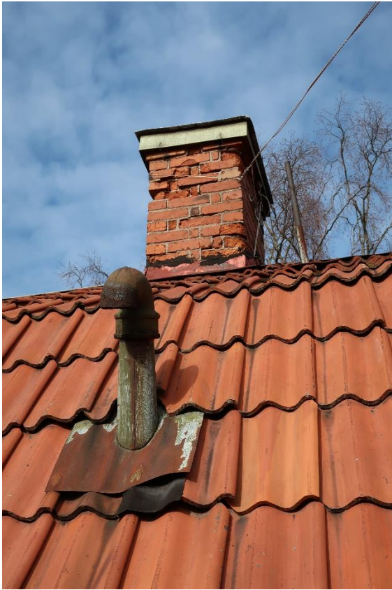
Skorsten och ventilation med åtgärdsbehov.
