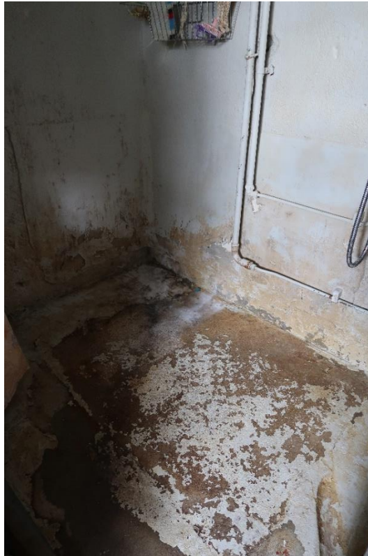
Fuktskador i badrummet i källaren.
