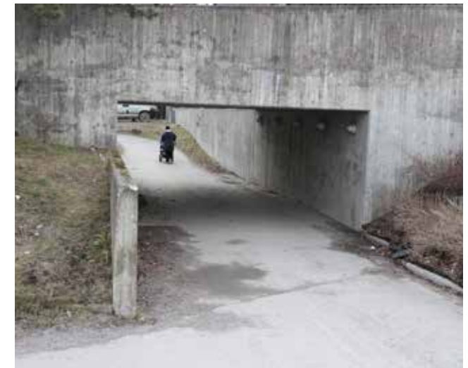
Gång- och cykeltunnel vid panncentralen
