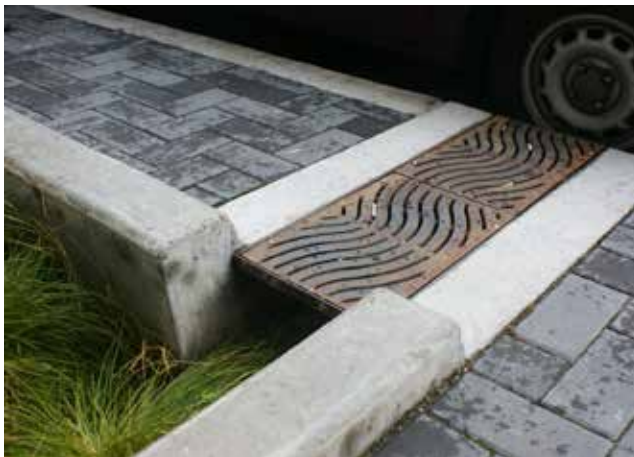
Referensbild, SWECO, dagvattenhantering, vattenränna
