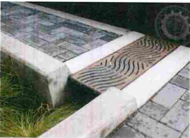
Referensbild, SWECO, dagvattenhantering, vattenränna
