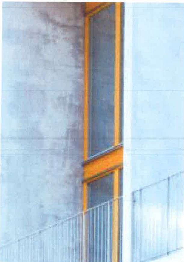
Referensbild: Fönsterkarmar utförda i gul accentkulör som bryter mot fasadens material (Källa: JOLIARK).
