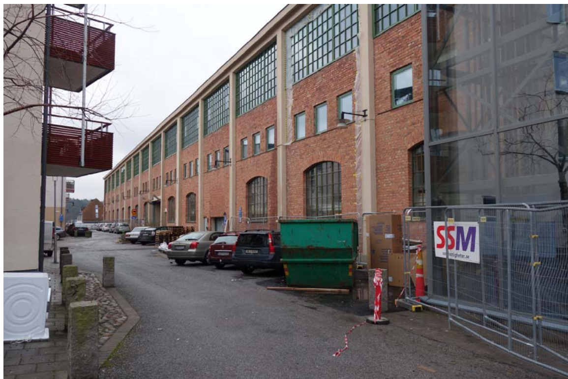
Turbinhallens östra fasad efter ombyggnad. Fönsterbandet närmast tak är utbytt, dock utan den ursprungliga indelningen i sex tydliga fält vilket påverkar byggnadens kulturhistoriska värde negativt. Foto 2017 11 20
