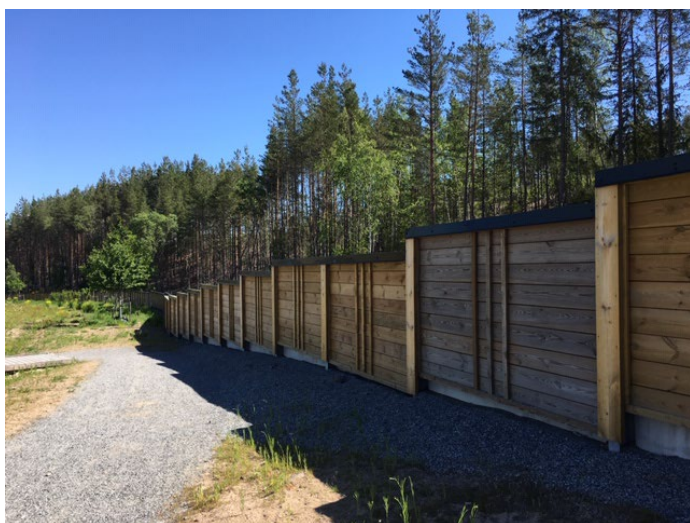
Plank, Älta 10:1, tillsynsbesök 2020-06-10
