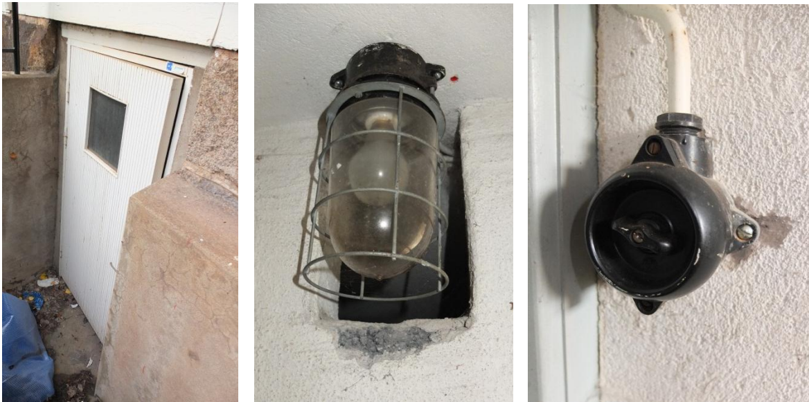
Entrén till källaren samt äldre armatur och strömbrytare av bakelit i källaren. Foto: Fredrika Mellander Rönn, Tyréns AB
