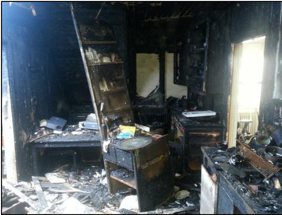
Rum 202, brandskadat kök, Foto: Jonas Sundwall, Tyréns AB
