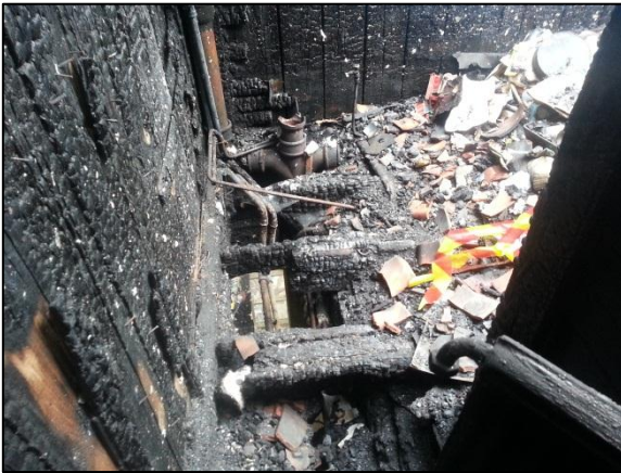
Rum 204 brandskadade väggar och bjälklag Foto: Jonas Sundwall, Tyréns AB
