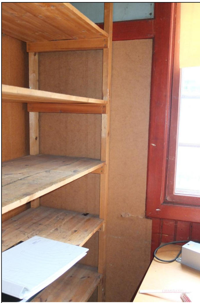
Fasta hyllor, röd pärlspont, fönsterfoder och horisontellt listverk i rum 104. Foto: F. Mellander Rönn, Tyréns AB
