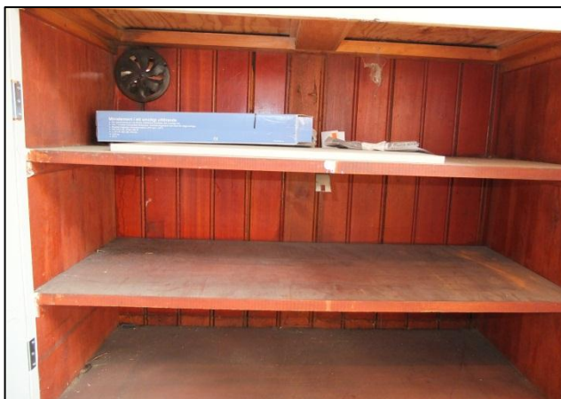
Insida av fast skåp i rum 103 Foto: F. Mellander Rönn, Tyréns AB.
