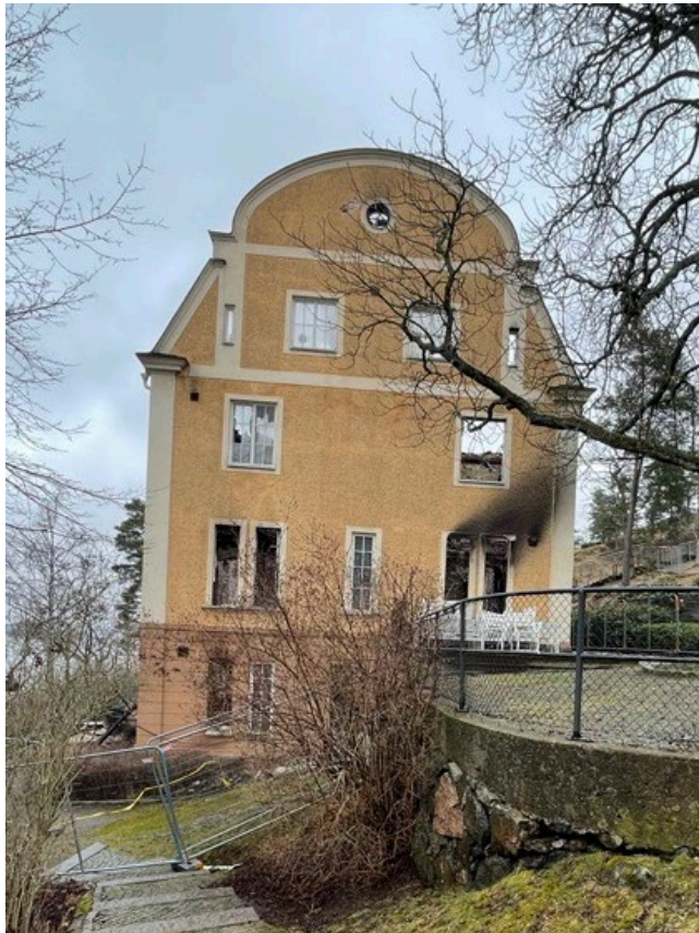
Bild 13. Fasad mot väster. Putsen är sotad från två fönster men har flera fönster kvar.
