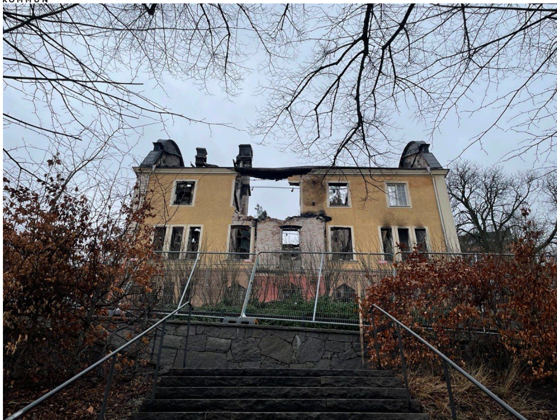
Bild 10. Fasad mot söder. Brandens påverkan på fasaden är tydlig genom bl.a. hål i fasaden.
