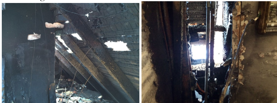
Foton från skaderapport utförd av Eye4Quality den 4 juli 2014 visar hål i tak och avbrända bjälkar.
