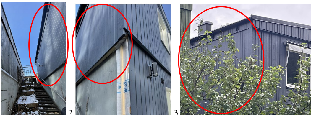
1. Fasad mellan husen som inte rättats gällande panel. Berörd fasad inom röd ring. 1-2. Foto från tillsynsbesök 25 februari 2022. 3. Foto från tillsynsbesök 17 oktober 2023.
