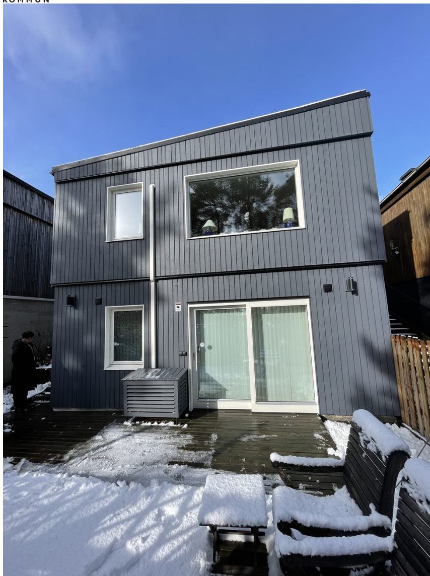
Bild 6. Gavelfasad med bytt panel vid uteplats. Det framgår även att fönster och altandörr är utbytta.
