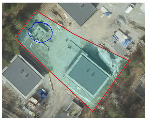
Flygfoto från 7 maj 2023 som visar att byggnation är påbörjad, grunden för komplementbostadshuset är inringad i blått.
