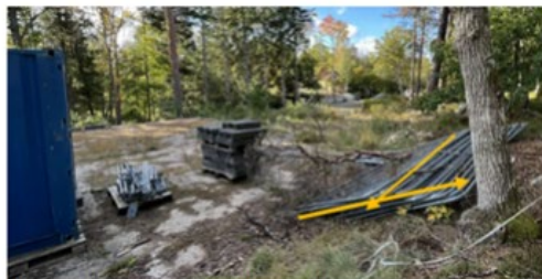
Byggstaket uppmättes ligga plcerade på en yta om 3x3,5 meter, se orangea pilar.
