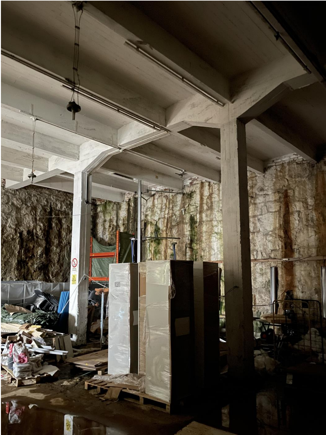
Delar av den befintliga, platsgjutna betongkonstruktionen. Spåren efter gjutformen är en viktig del av karaktären.
