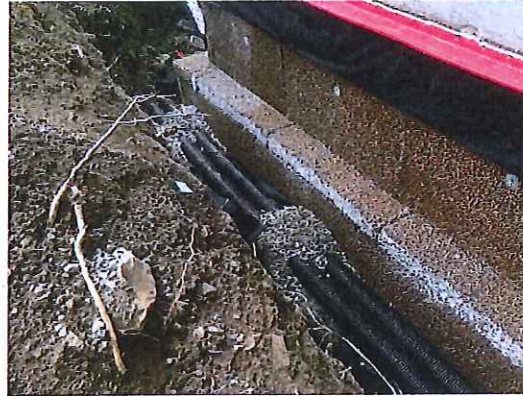
Bild 3. Dubbladningsrör runt huset
