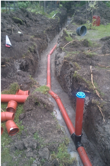
Bild 2. Dräneringsledningarna runt huset samt ner till brunnen
