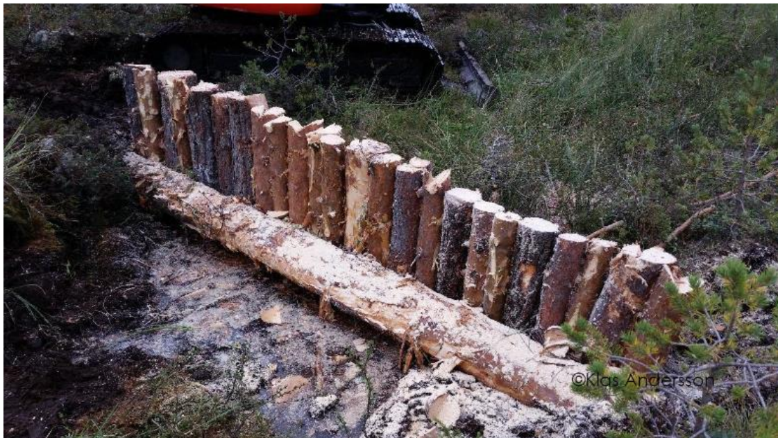
Figur 18. Dämme med ensidig tråkärna. Det krävs oftast minst två personer på plats för att göra dessa dämmen: en maskinist och person som kan hantera motorsåg och göra bedömning av höjd och bredd på dämmena. Själva tråkärnan behöver inte löpa hela vägen ut i terrängen från diket utan det räcker ofta att det går in 0,3–0,6 meter i dikeskanten för att det ska vara stabilt. En gripklo är ett tillbehör som bör krävas att entreprenören har på maskinen. Detta verktyg underlättar arbetet med virke Foto: Klas Andersson, väg och miljö AB.
