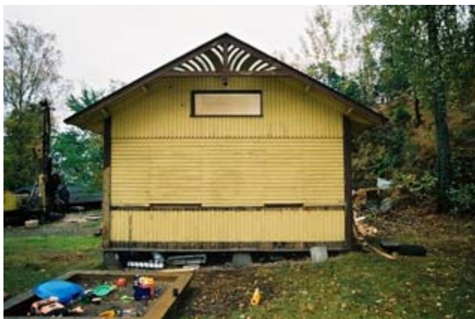
Hus 3 Bostadshus f.d. tvättstuga från väster. Igensatta ursprungliga fönster.
