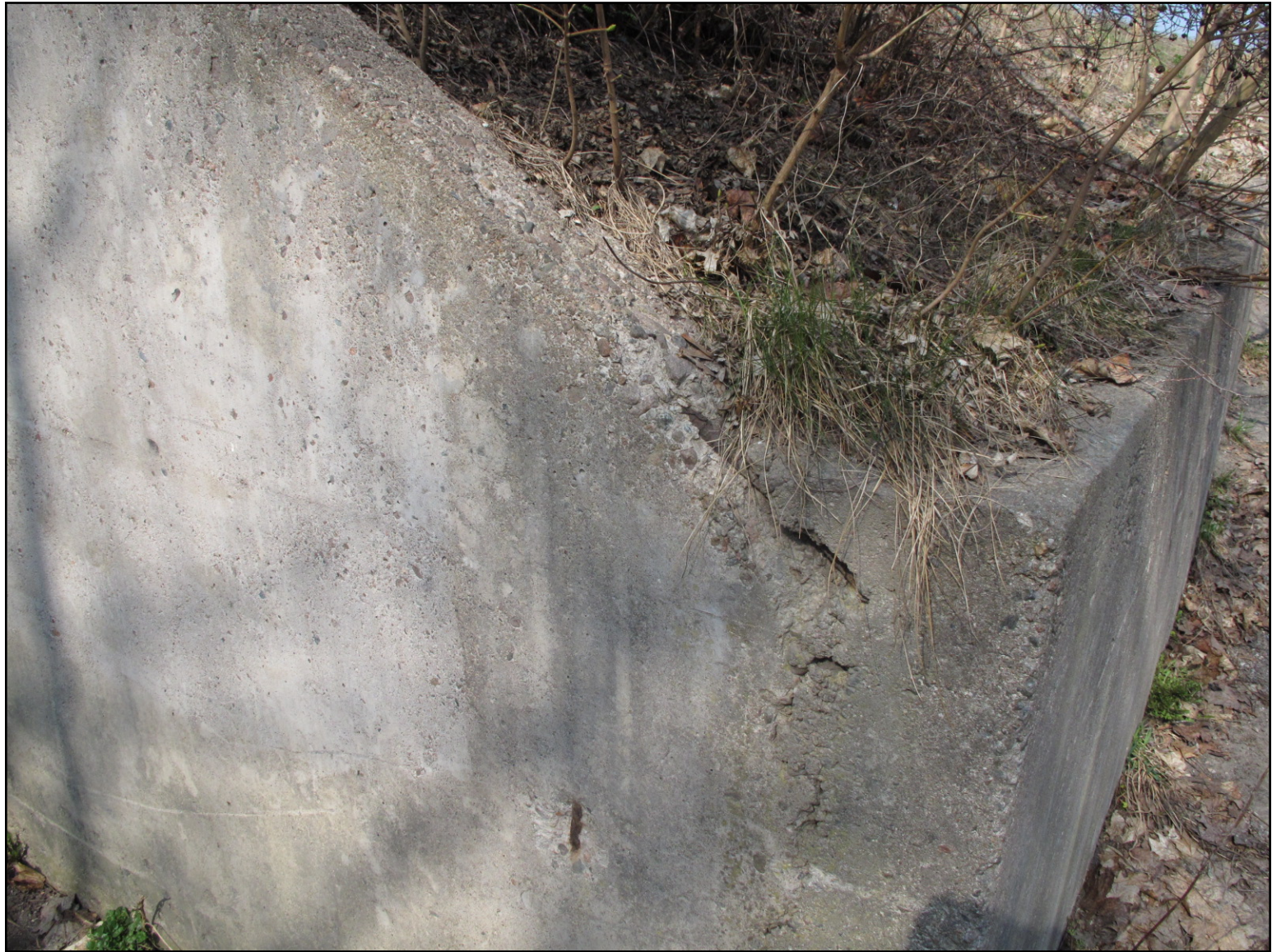
3 - Vingmur - Armeringsstål - Korrosion 2010-04-27 Ett flertal spjälkningar samt vittringar
