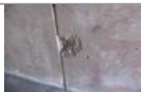
1 - Frontmur - Armeringsstål - Korrosion 2010-04-27
