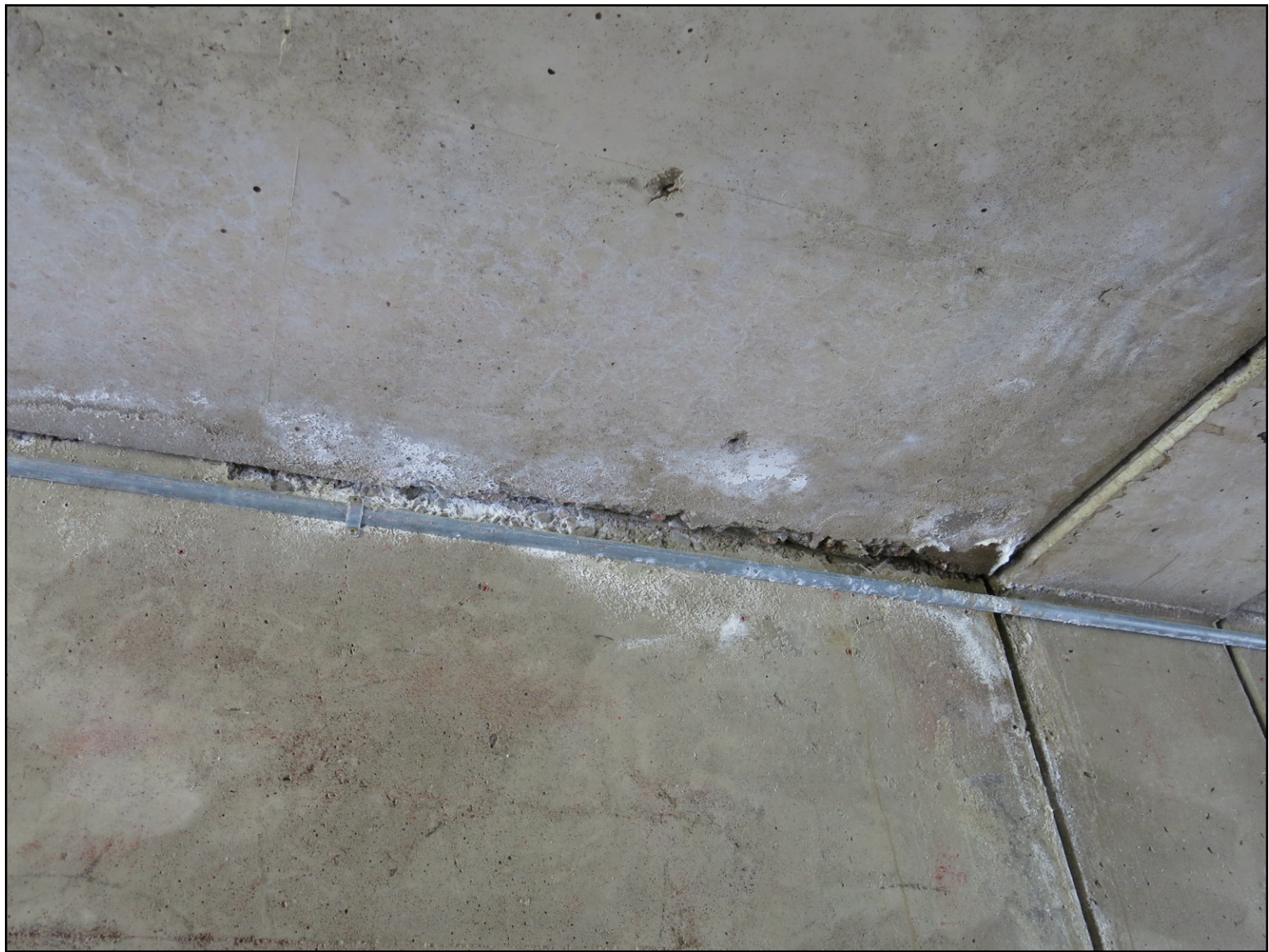
4 - Tätskikt - Gjutasfalt - Defekt 2015-05-27
