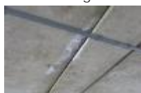
4 - Tätskikt - Gjutafalt - Defekt 2015-05-27
