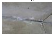
4 - Tätskikt - Gjutafalt - Defekt 2015-05-27
