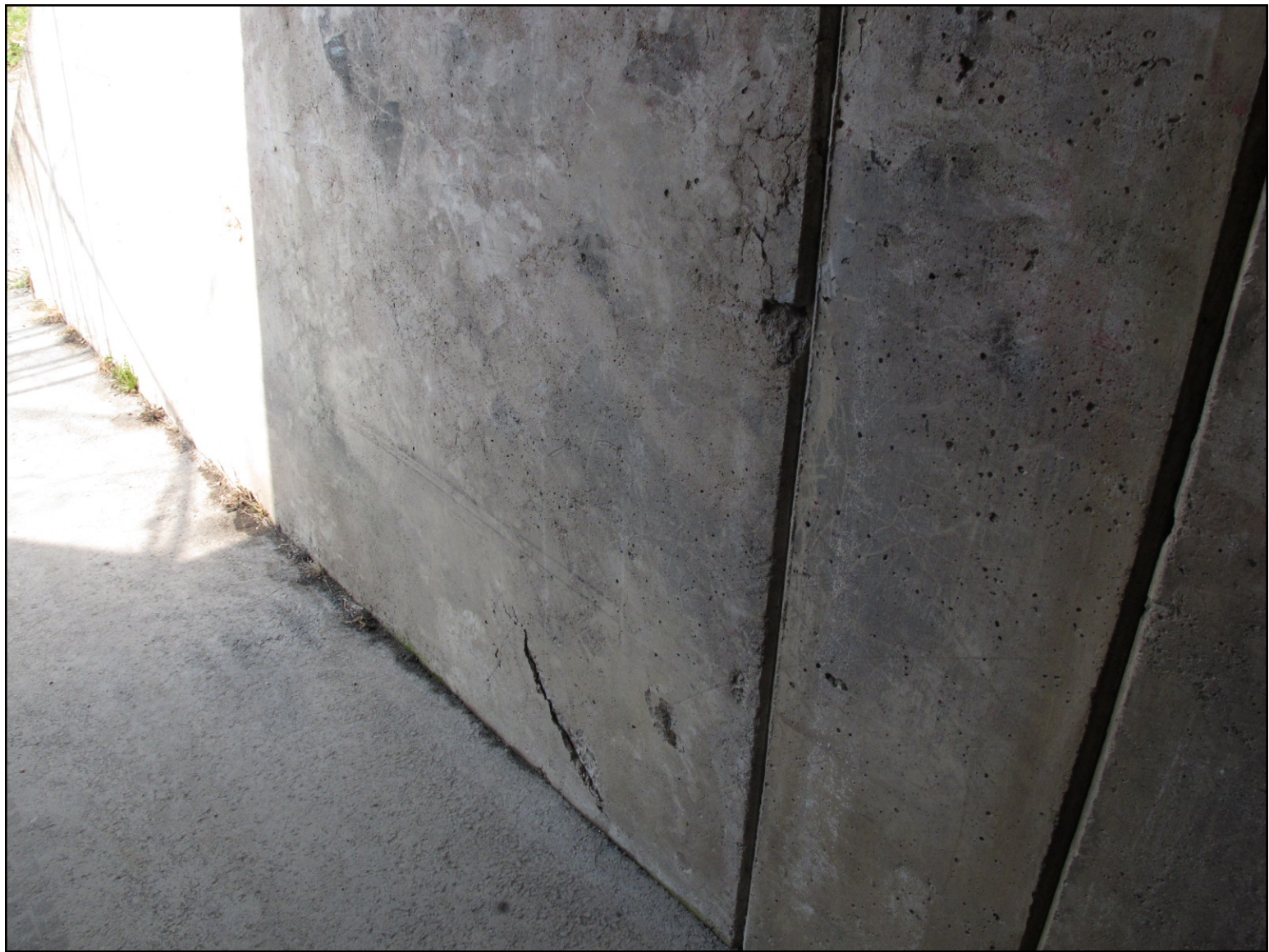
1 - Frontmur - Armeringsstål - Korrosion 2010-04-27 Ett flertal spjälkningar och vittringar
