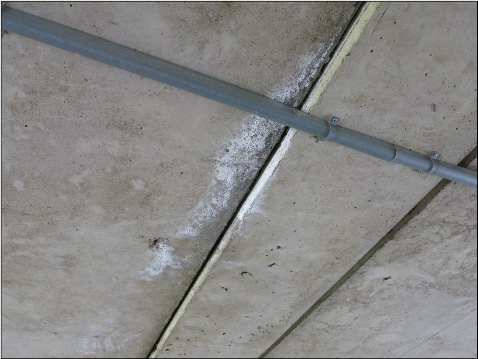
4 - Tätskikt - Gjutafalt - Defekt 2015-05-27
