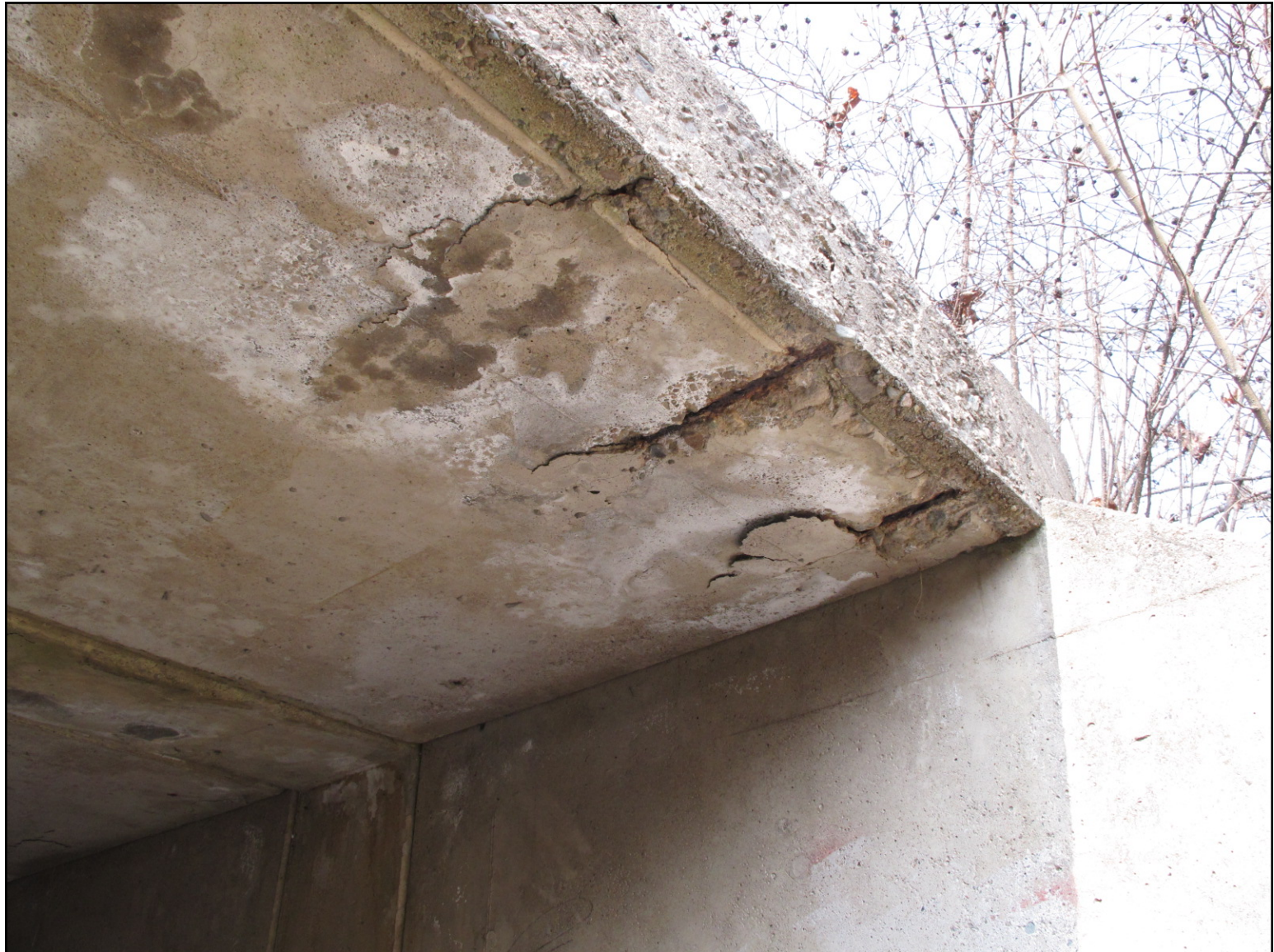
2 - Platta - Armeringsstål - Korrosion 2010-04-27 Ett flertal spjälkningar samt vittringar
