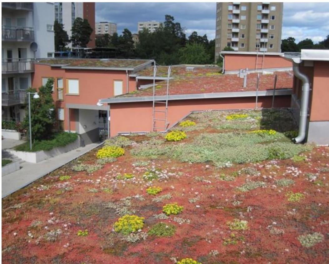
Figur 7.5. Sedumtak i Hässelby ( www.vegtech.se )
