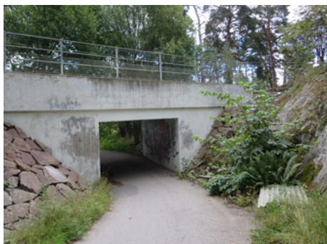
Trång gångport vid Igelboda skola. Brant lutning och kurva ger dålig sikt och därmed risk för otrygghet
