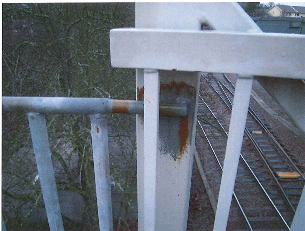
Dåligt utförd målning samt endast häftsvetsad.
