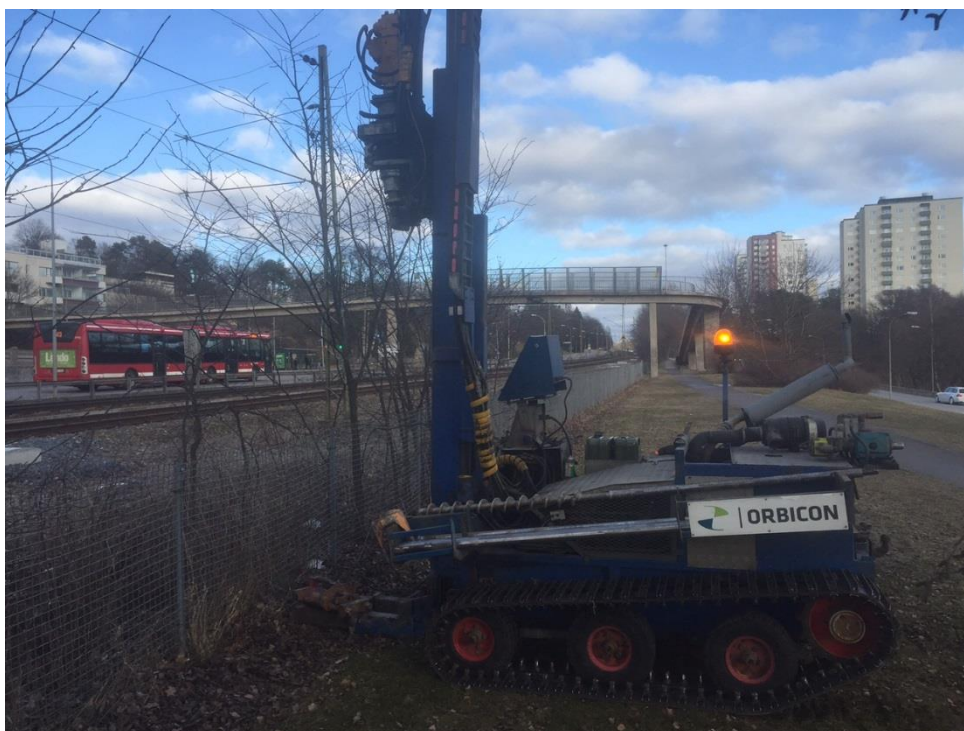
Foto 4. Borring av provpunkt BH10 i planområdet östra del. Halter av metaller påträffades över Naturvårdsverkets riktvärden för KM mellan 0,5-1,0 m.u.my. Borring utfördes ner till 1,5 m.u.my då borrstopp erhöles.
