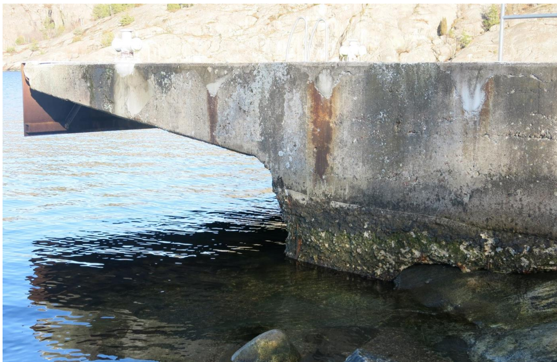
Foto 2, vittrad betong med synlig armering.
