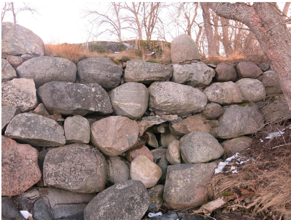
Foto 6, ras i muren.
