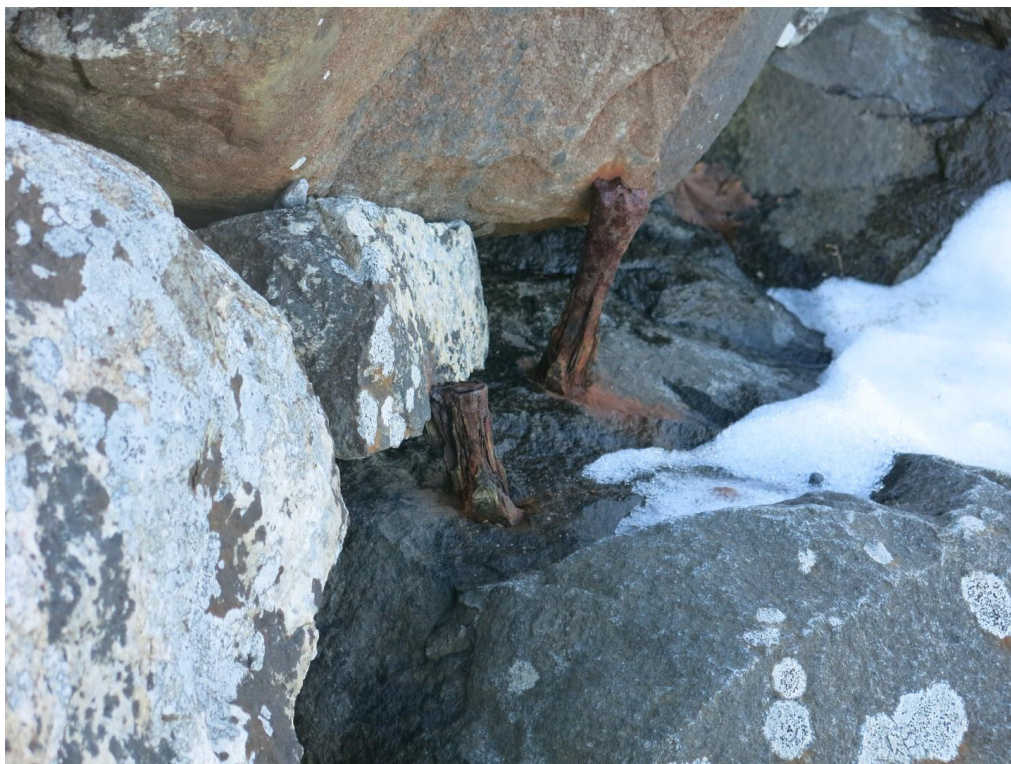
Foto 5, korroderade järn som håller nedersta stenen på plats.
