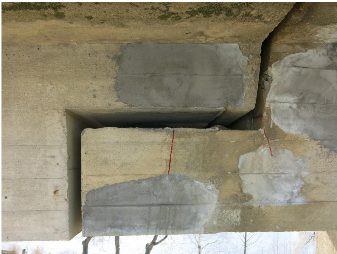
Foto 5 Hakupplag. Tidigare utförda lagningar synliga.
