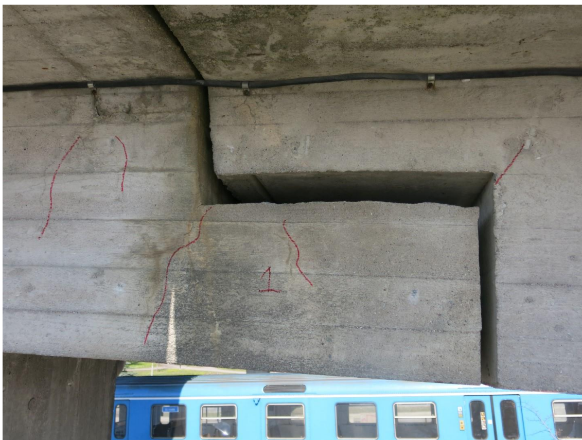
Foto 6 Hakupplag. Sprickor markerade med rött.
