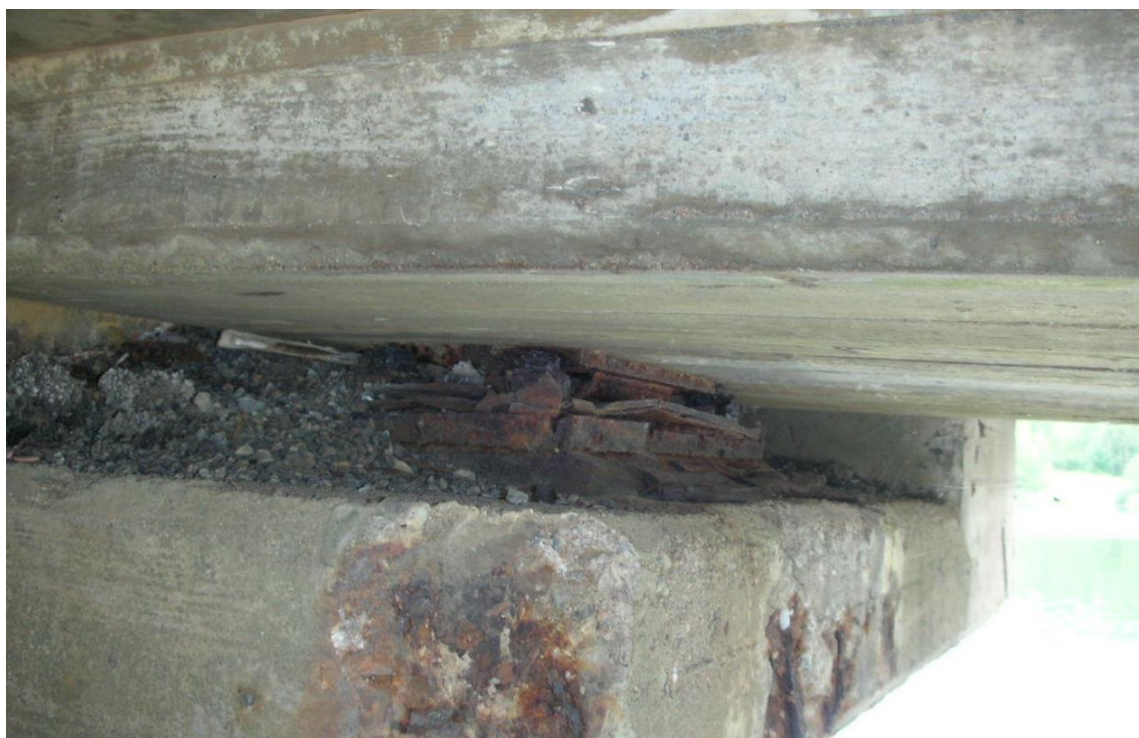
Figur 8: Lagerkonstruktion med omfattande korrosionsskador och sannolikt obefintlig funktion.
