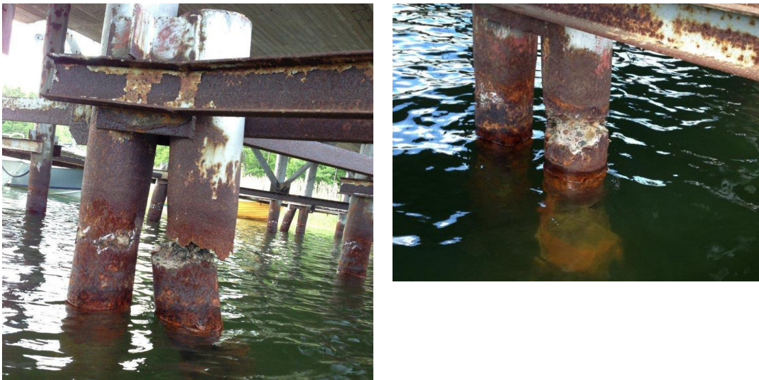
Figur 5: Representativa korrosionsskador som orsakat brott respektive omfattande materialförlust i brostöd.
