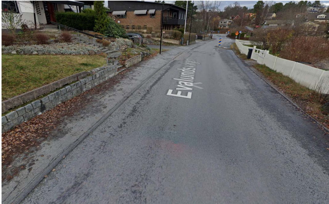
Kantstöden på flertal sträckor är utfört med asfaltsmassa som lätt slits och pressas ner av tunga fordon som förlorar funktion som barriär mot gående. Här nära busshållplatsen Nyvägen sett norrut.
