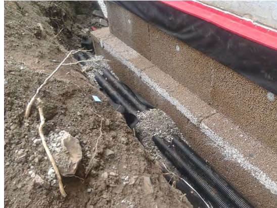
Bild 3. Dubbladräneringsrör runt huset
