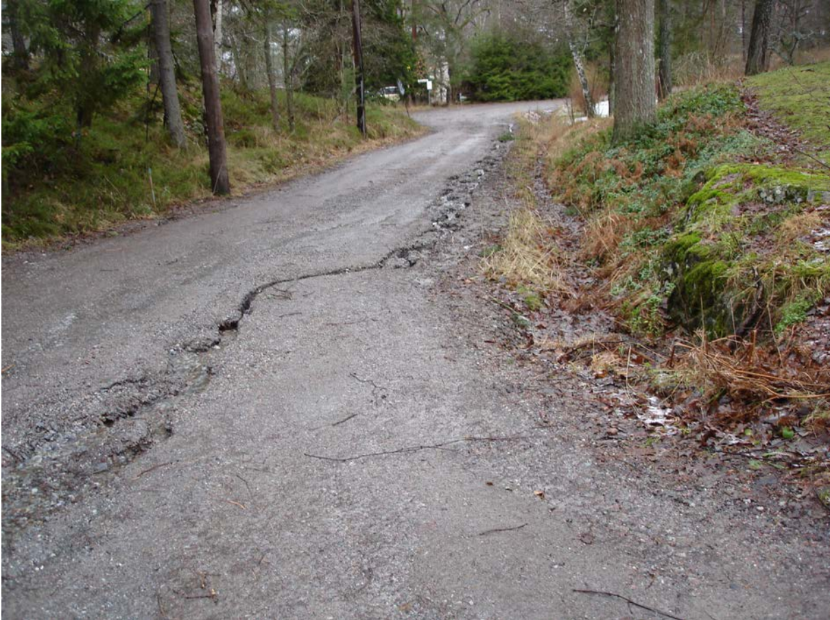
Skador på väg orsakade av bristfällig dagvattenhantering
