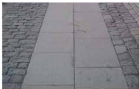
Exempel: Granithällar ska sättas av tillgänglighetsskäl.
