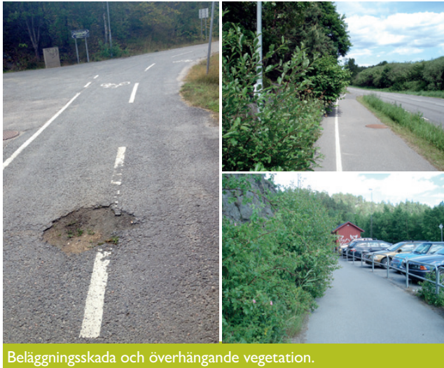
Beläggningsskada och överhängande vegetation.
