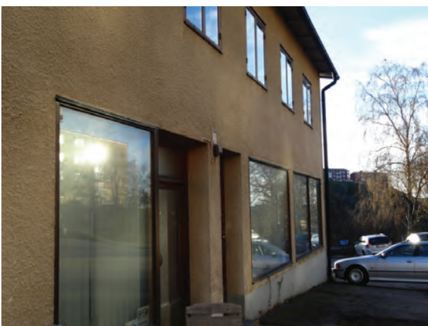
Butiksfönster med bågar av teak. Entrédörrarna är till skillnad från fönstren indragna från fasadliv. Sockeln är putsgrå.
