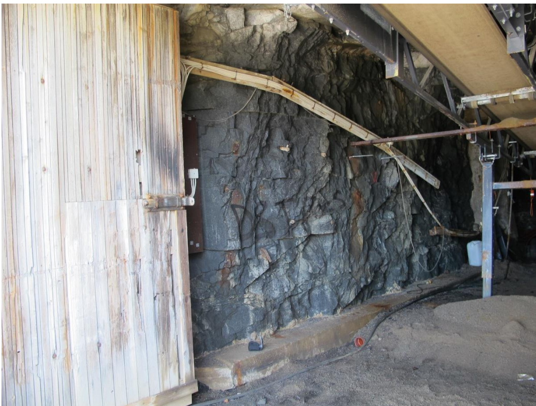
Figur 6 Västra väggen av tunneln är mer sprängskadad
