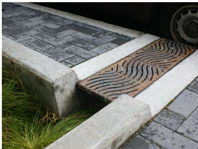
Referensbild, SWECO: dagvattenhantering, vattenränna
