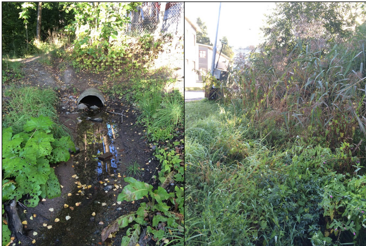
Figur 3-11. Fotografi till vänster visar diketets början vid den före detta kyrkogårdens nordöstra hörn. Cirka halva trummans dimension (Ø 600) är igenfylld med sand och sediment. Fotografi till höger visar representativ vegetation i diket.
