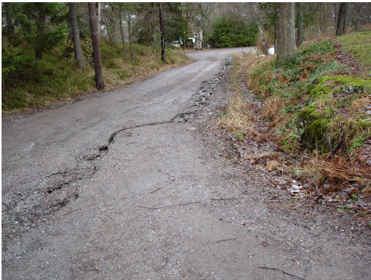
Skador på väg orsakade av bristfällig dagvattenhantering
